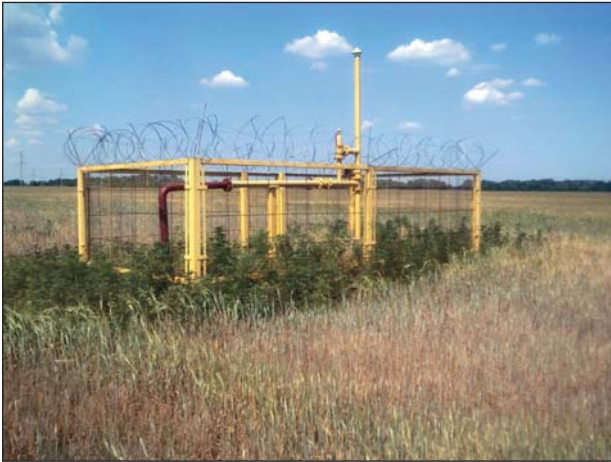
Рис. 3. Обустроенное устье скважины
